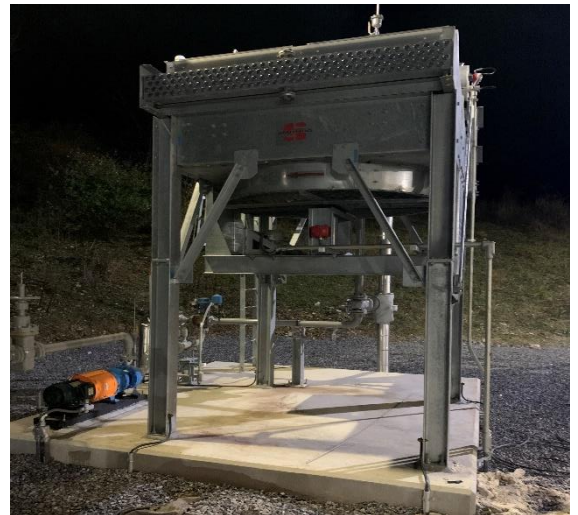
Example Aux Cooling Fin Fan and
